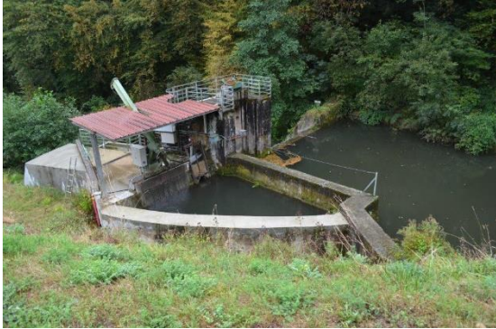
Prise d'eau St Bueil
